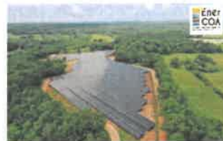
Parc photovoltaïque citoyen 4 MW GDS + Laramière + Ouest Aveyron Communauté + SEM Lot Énergies Nouvelles + SCIC Enercoa (428 k€ citoyens)
